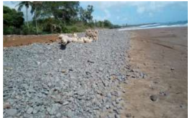
Photo 12 : Digue naturelle d'enrochements basaltiques sous forme de beach rock (scories basaltiques saines)
